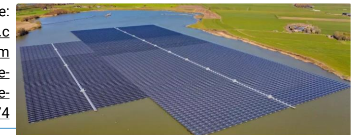
© BayWa re. Das Potenzial von schwimmenden Photovoltaik (PV)-Anlagen, sogenannten Floating-PV-Anlagen, liegt in Deutschland bei über 2 GWP.
